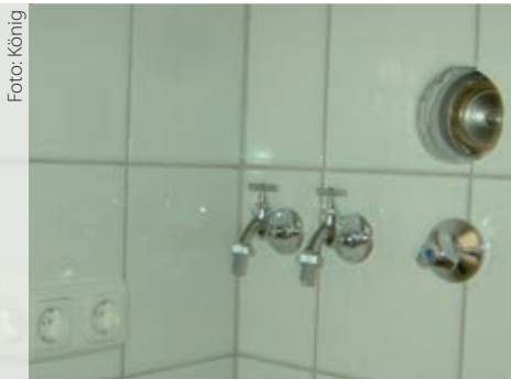
Doppelter Wasserhahn im Bad. Die Mieter haben die Wahl, ob sie gebührenpflichtiges Trinkwasser oder kostenloses Grauwasser für die Waschmaschine nutzen
