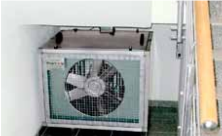
Ein Ventilator im Erdgeschoss sorgt im Brandfall für Überdruck im Treppenhaus.
